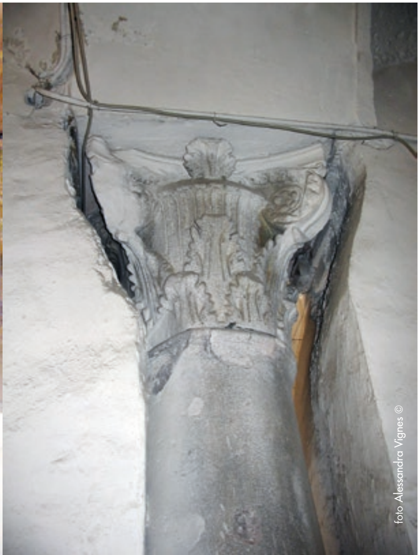
Particolare delle colonne della chiesa di San Massimo (archivio privato Arch. Vignes, anno 2006)
